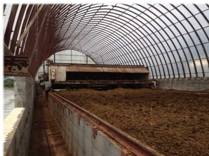
発酵堆肥化施設
